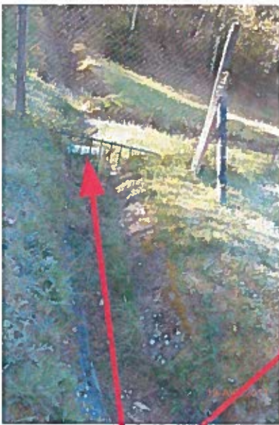
Buse débouchant dans le bassin de collecte
